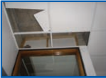
AIB fire stop over door
